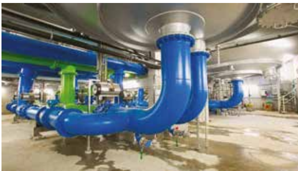
Een typische opstelling van een zogenaamde 'onthardingsinstallatie'.
